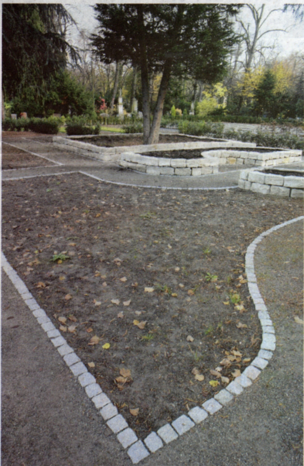
Derzeit ruht die Baustelle, weil die Genehmigung fehlt: Die Friedhofsgärtner-Genossenschaft will auf Melaten einen Bestattungsgarten anlegen.
